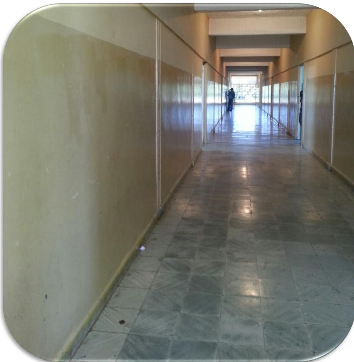
Figura # 5, paredes del centro sin presentar ningún tipo de señalización de ruta de evacuación.
