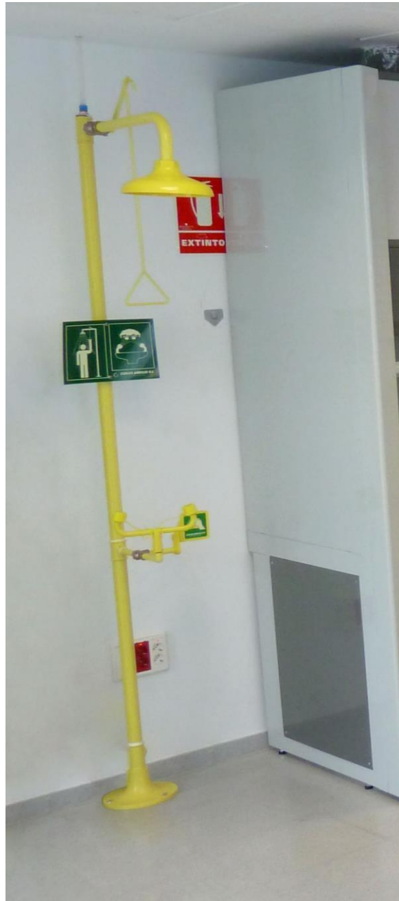
Ducha de seguridad Fuente: Haleco (2013) Anexo #6
