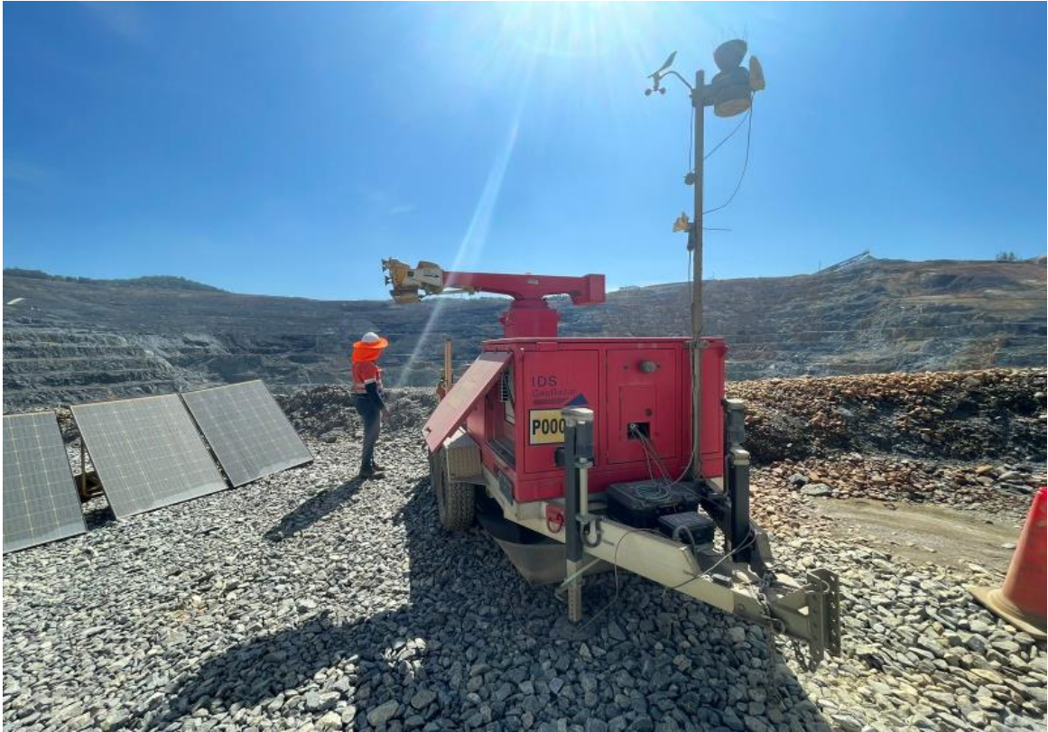
Figura 28: Sistema de monitoreo geotécnico. IDR GeoRadar.
