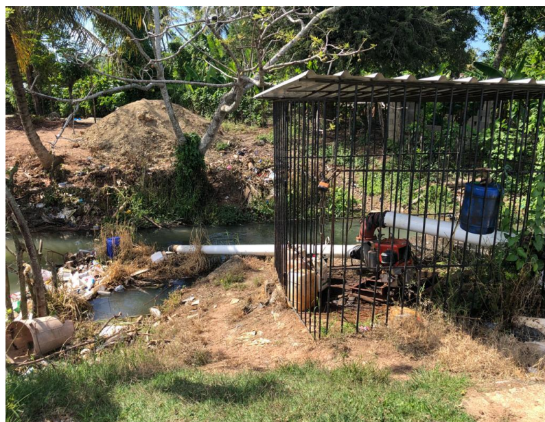
Foto 13: Bomba de agua centrífuga.
