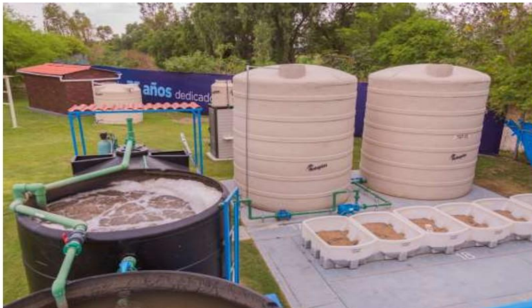
Figura No. 5 Sistema modular para el tratamiento de aguas residuales.
