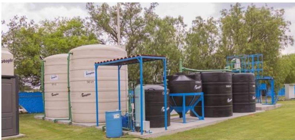
Figura No. 4 Sistema modular para el tratamiento de aguas residuales.
