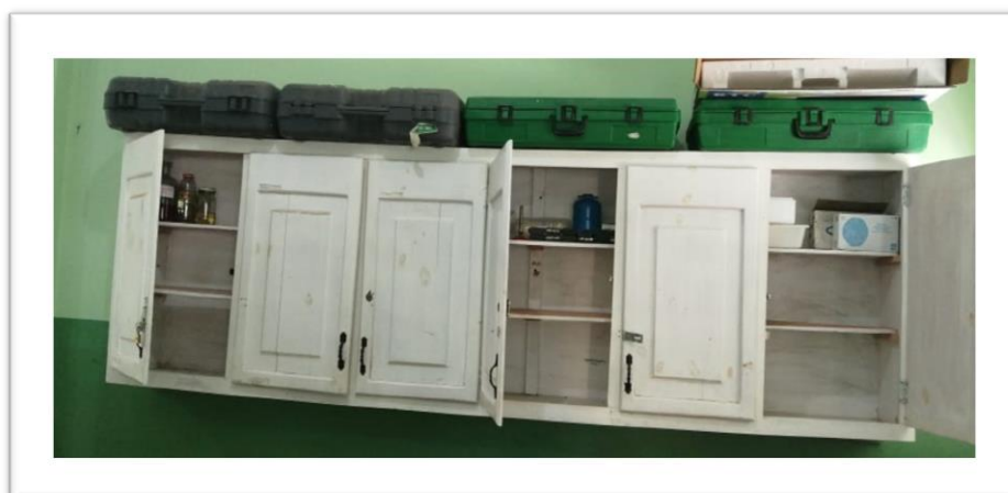
Fotos de los gabinetes presente en el aula; evidente la necesidad de reparación
