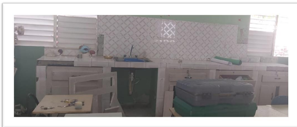
Estado de deterioro de las mesetas del antiguo Laboratorio de Ciencias de la Naturaleza
