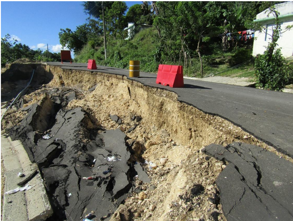
Fig.9. Cicatriz Deslizamiento Carretera San Víctor - Amaceyes Arriba
