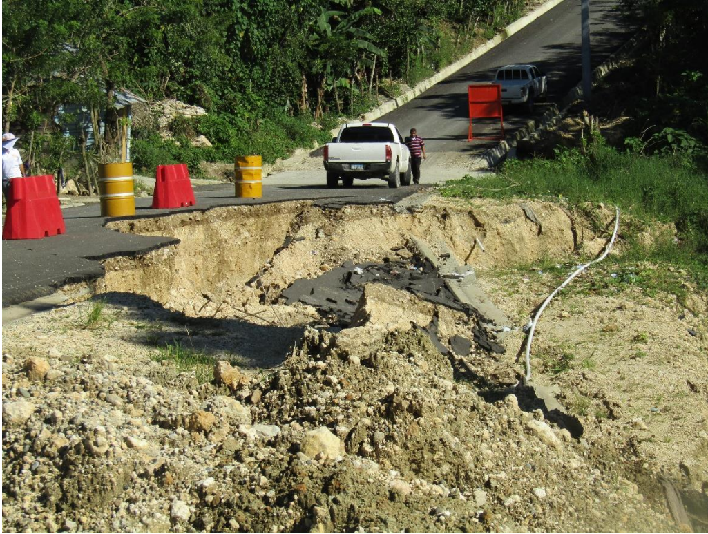
Fig.10. Cicatriz Deslizamiento Carretera San Victor - Amaceyes Arriba
