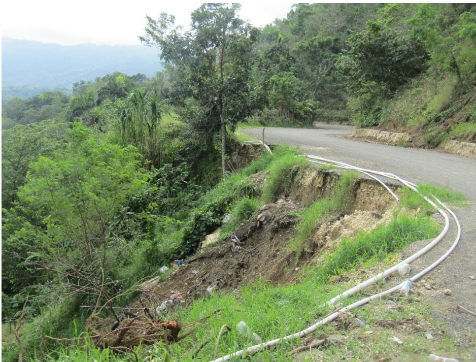
Fig.7. Deslizamiento Canca La Piedra - Amaceyes Arriba
