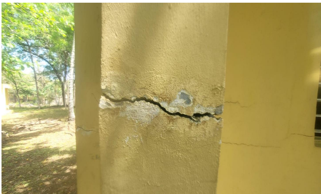
Figura 4: Fallas en elementos estructural modulo B
