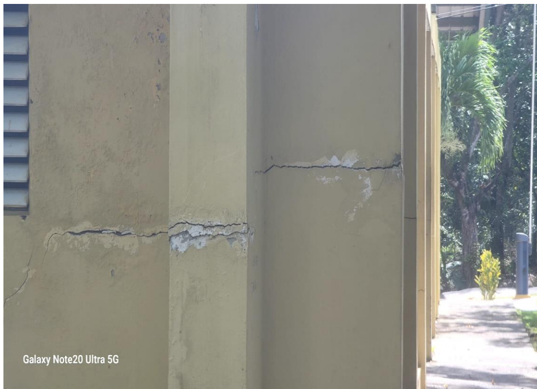
Figura 3: Fallas en elementos estructurales módulo A
