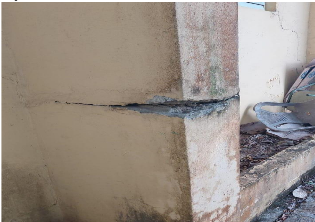
Figura 6: Fallas en elementos estructurales módulo C
