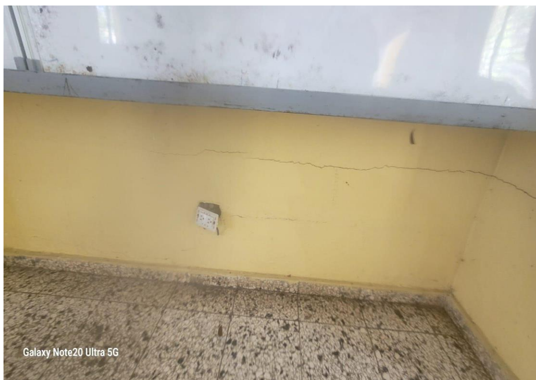
Figura 5: Fallas en elementos estructural modulo B
